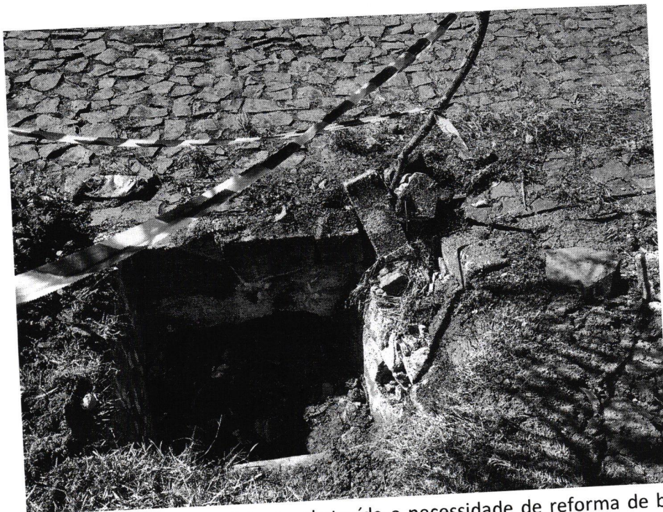
Foto 02: Drenagem existente obstruída e necessidade de reconstrução de boca de lobo.
