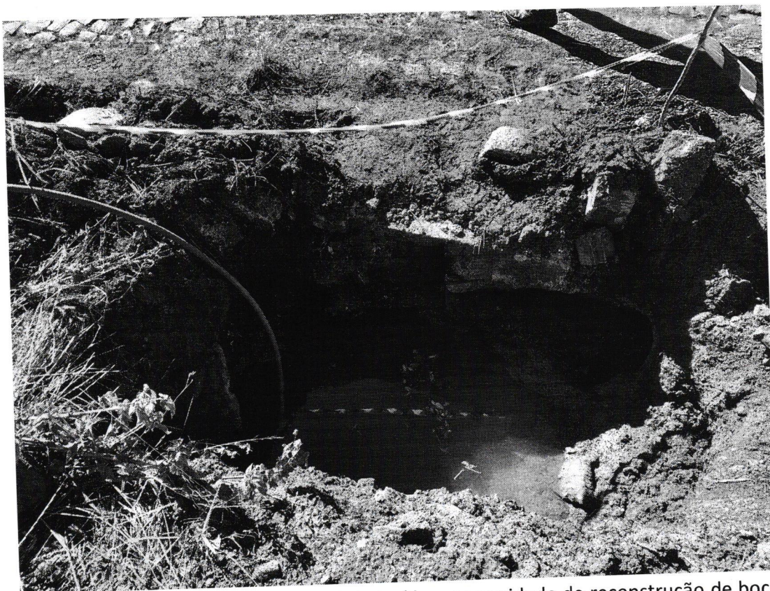
Foto 01: Drenagem existente obstruída e necessidade de reconstrução de boca de lobo.
