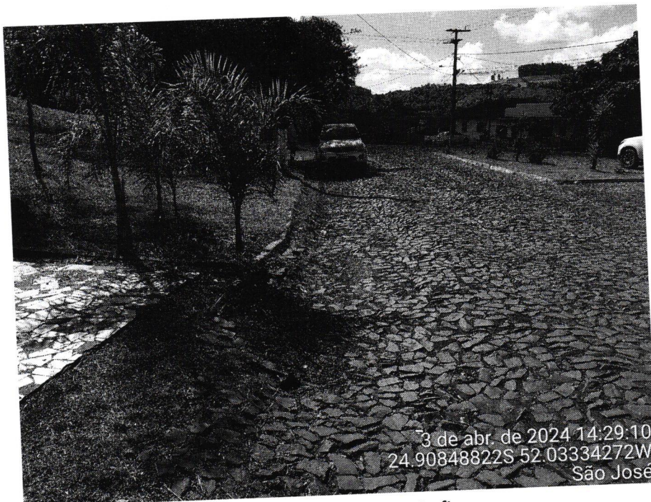
Foto 04: Necessidade de reconstrução de meio fio.
