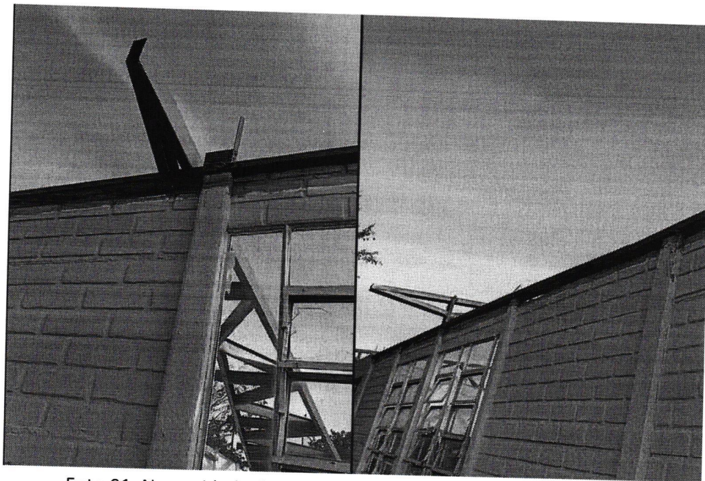
Foto 01: Necessidade de colocação de viga metálica de travamento.
