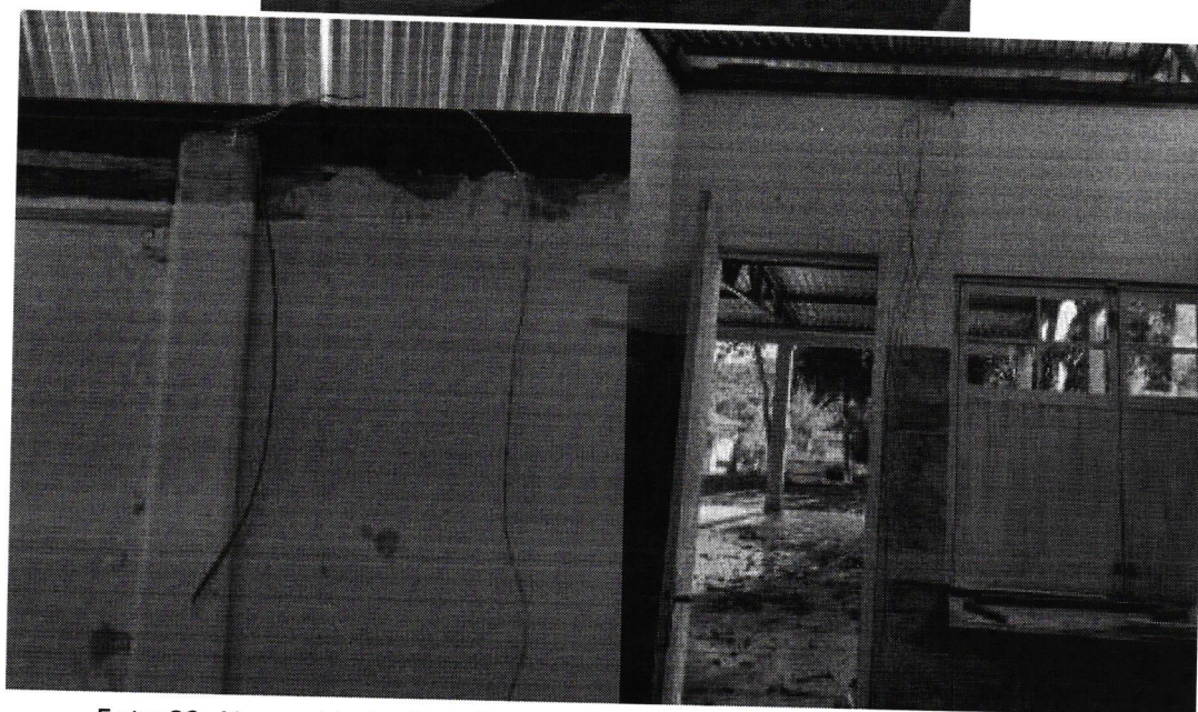
Foto 02: Necessidade de substituição da parte elétrica.
